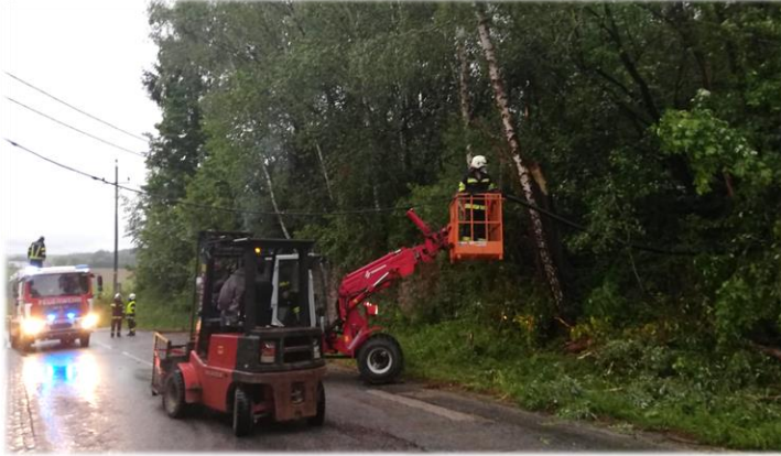
11. Mai: Sturmschaden an Stromleitung am Steinbruch
